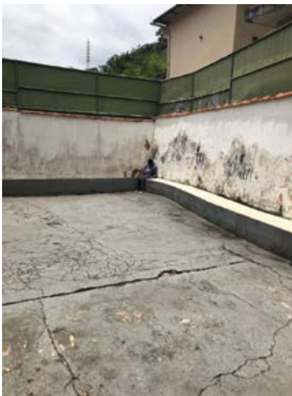
Fotografia 5: Casa de Saúde Santa Mônica, Petrópolis – RJ. Pátio composto por muretas para se sentar e, ao fundo, uma pessoa sentada sozinha na quina de altas paredes emboloradas, com cabeça baixa.
