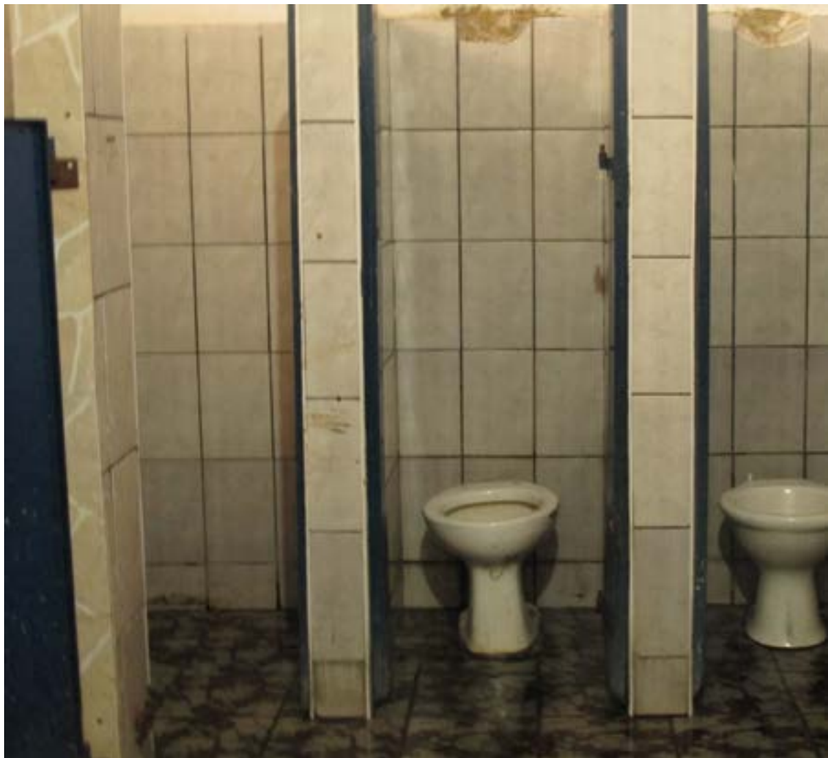
Fotografia 16: Casa de Saúde Cananeia, Vassouras - RJ. Na foto abaixo, banheiros sem porta.
